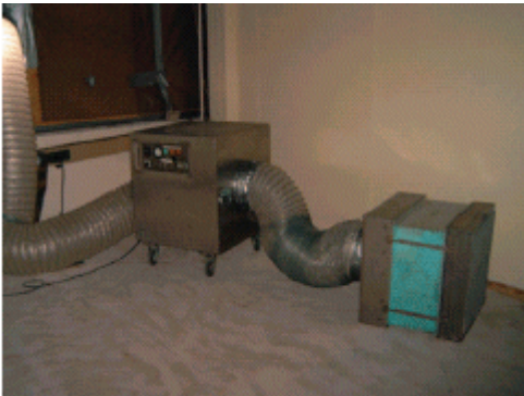
Bild 9: Technische Entlüftung bei starkem Schimmelpilzbefall
