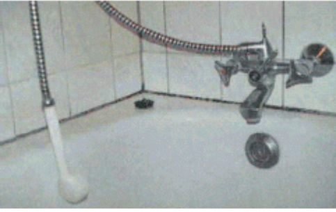
Bild 8: Beispiel für schwache Sporenexposition ("Ohne besondere Gefährdung") bei mit Schimmelpilzen befallenen Fugendichtungen
