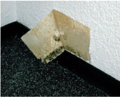
Bild 3: Schimmelpilzbefall unter der Tapete
