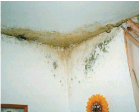
Bild 4: Schimmelpilzbefall undichtes Flachdach
